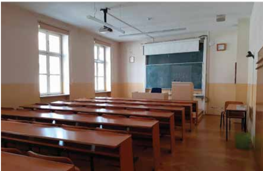
Oštećenja od potresa u učionicama i dvoranama
