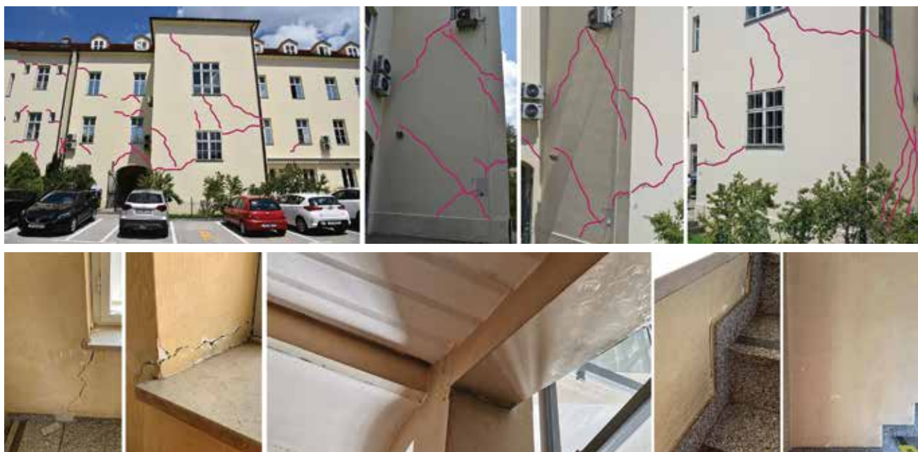
Pročelja zgrade Katoličkog bogoslovnog fakulteta s vidljivim oštećenjima nastalima nakon potresa
